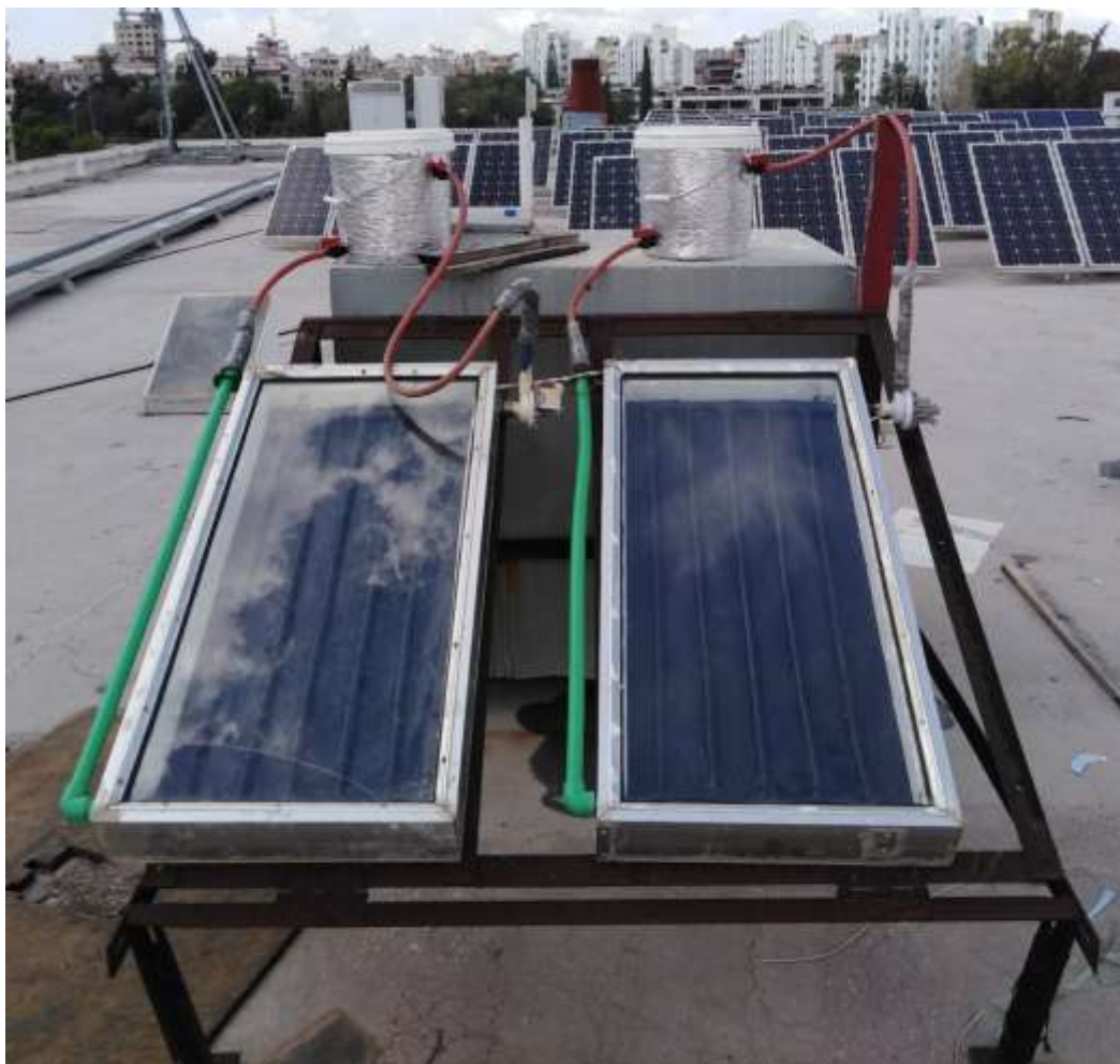
الشكل (1) وصل اللاقطين الشمسيين مع خزانات المياه
